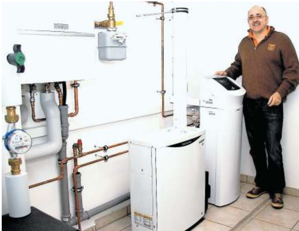
Jörg Blumberg vor der Musteranlage im Elternhaus. Kraft-Wärme-Kopplung ist die Formel zur Kosteneinsparung bei der Modernisierung einer Bestandsimmobilie.
